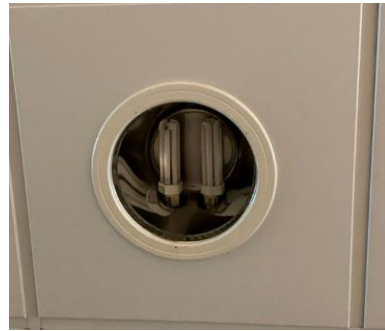
Figura 37 - lampada fluorescente 2x42 W
