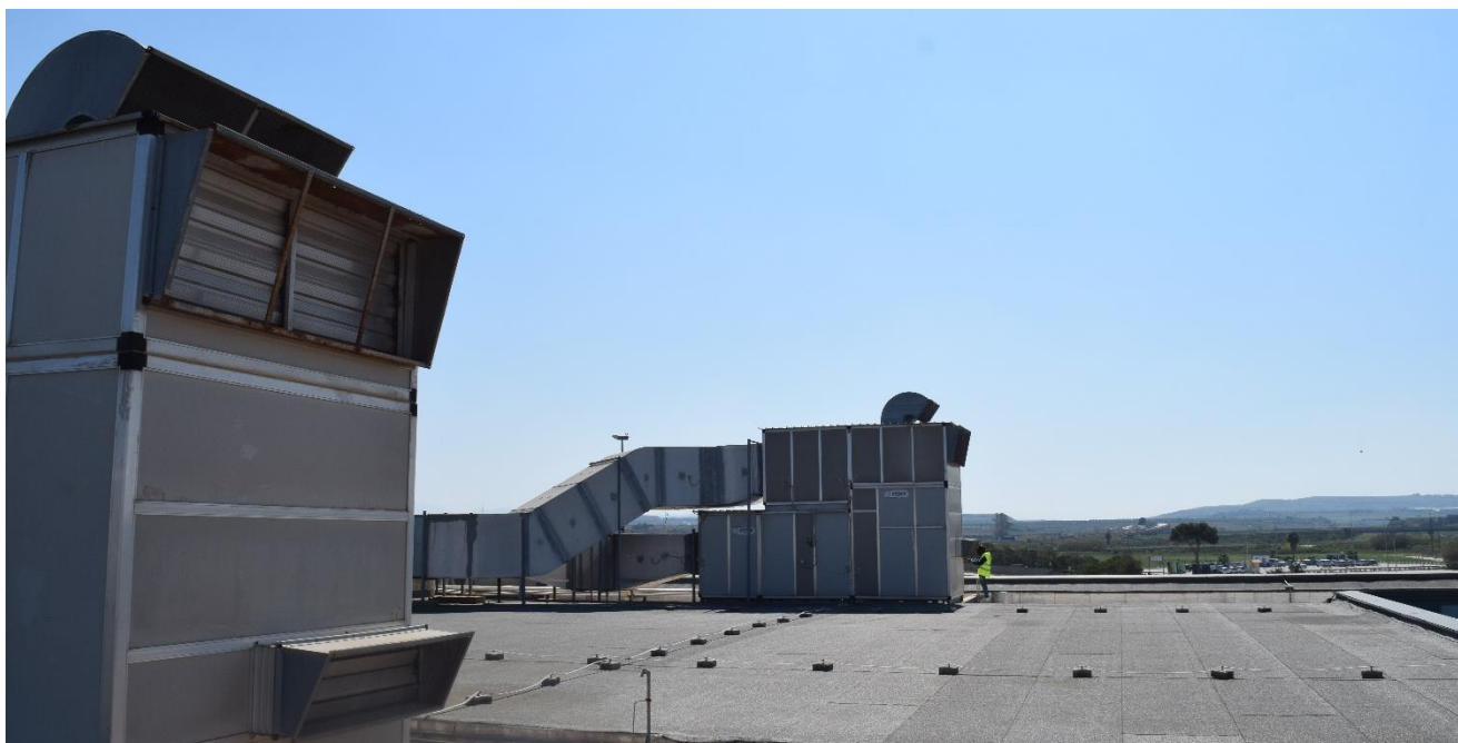
Figura 21 - Unità di Trattamento Aria in copertura
