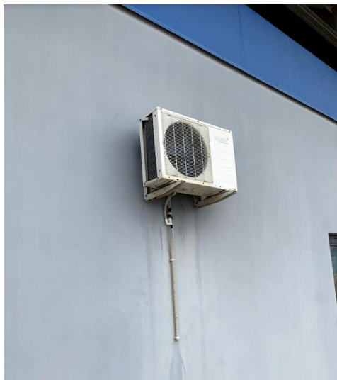
Figura 49 - unità esterna della pompa di calore ad espansione diretta
