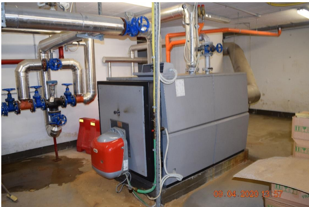
Figura 23 - Caldaia a gasolio Ferroli
