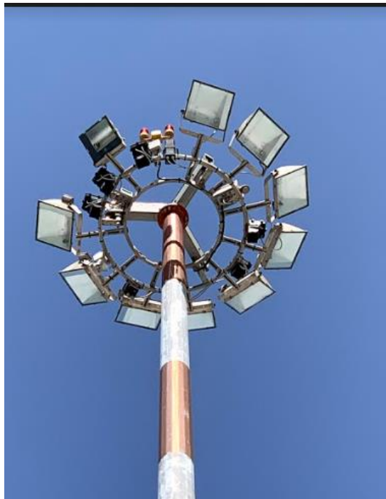
Figura 65 – torre faro SAO 400 E 1000 W
