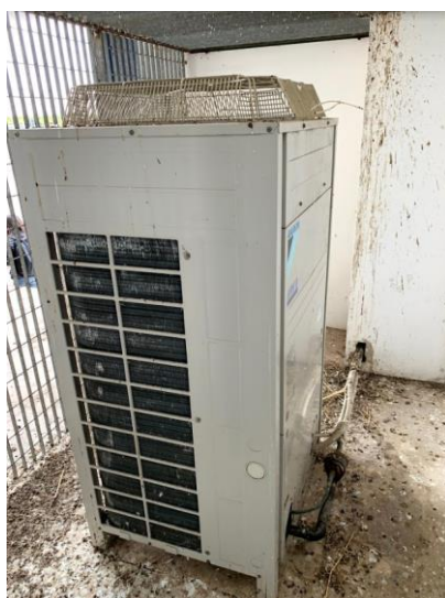
Figura 53 - unità esterna sistema VRV
