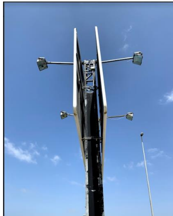
Figura 66 – proiettori vapori di mercurio 250 W zona parcheggio
