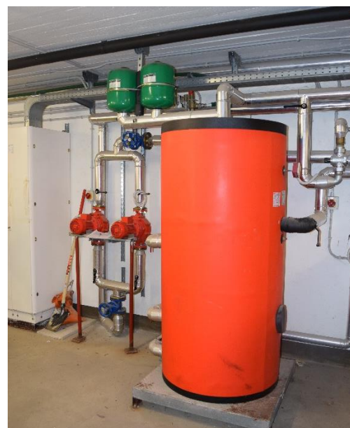
Figura 35 - Bollitore ad accumulo SICC da 800 litri all'interno della centrale termica
