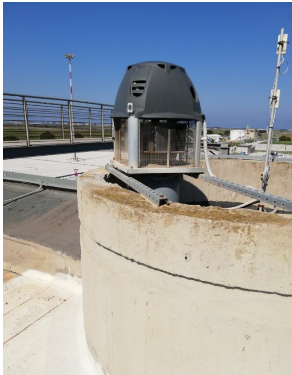
Figura 33 – torrino di estrazione aria dai WC
