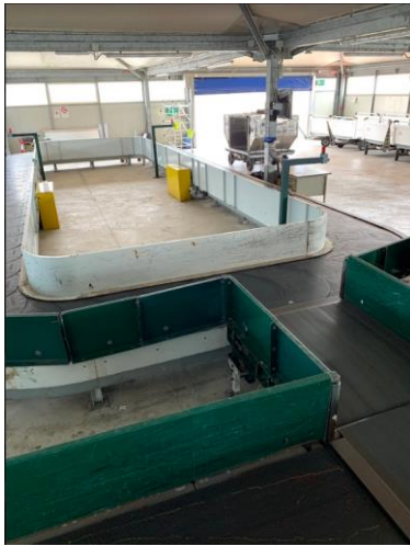
Figura 44 – Locale BHS - smistamento bagagli
