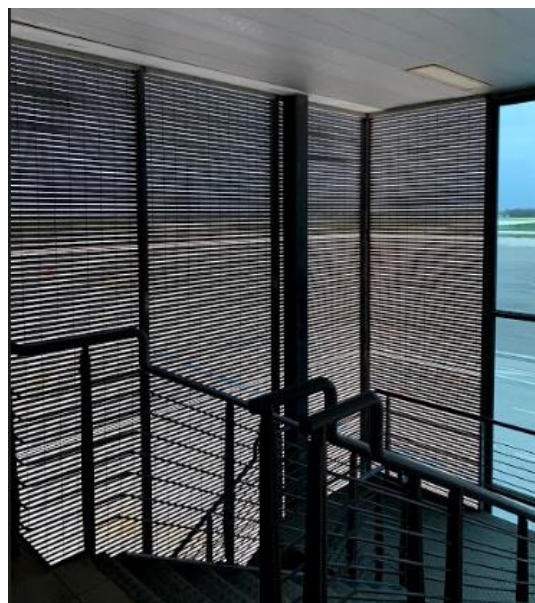
Figura 20 - Schermatura solare - vista interna
