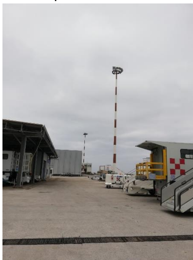
Figura 61 – Torri faro piazzale aeromobili
