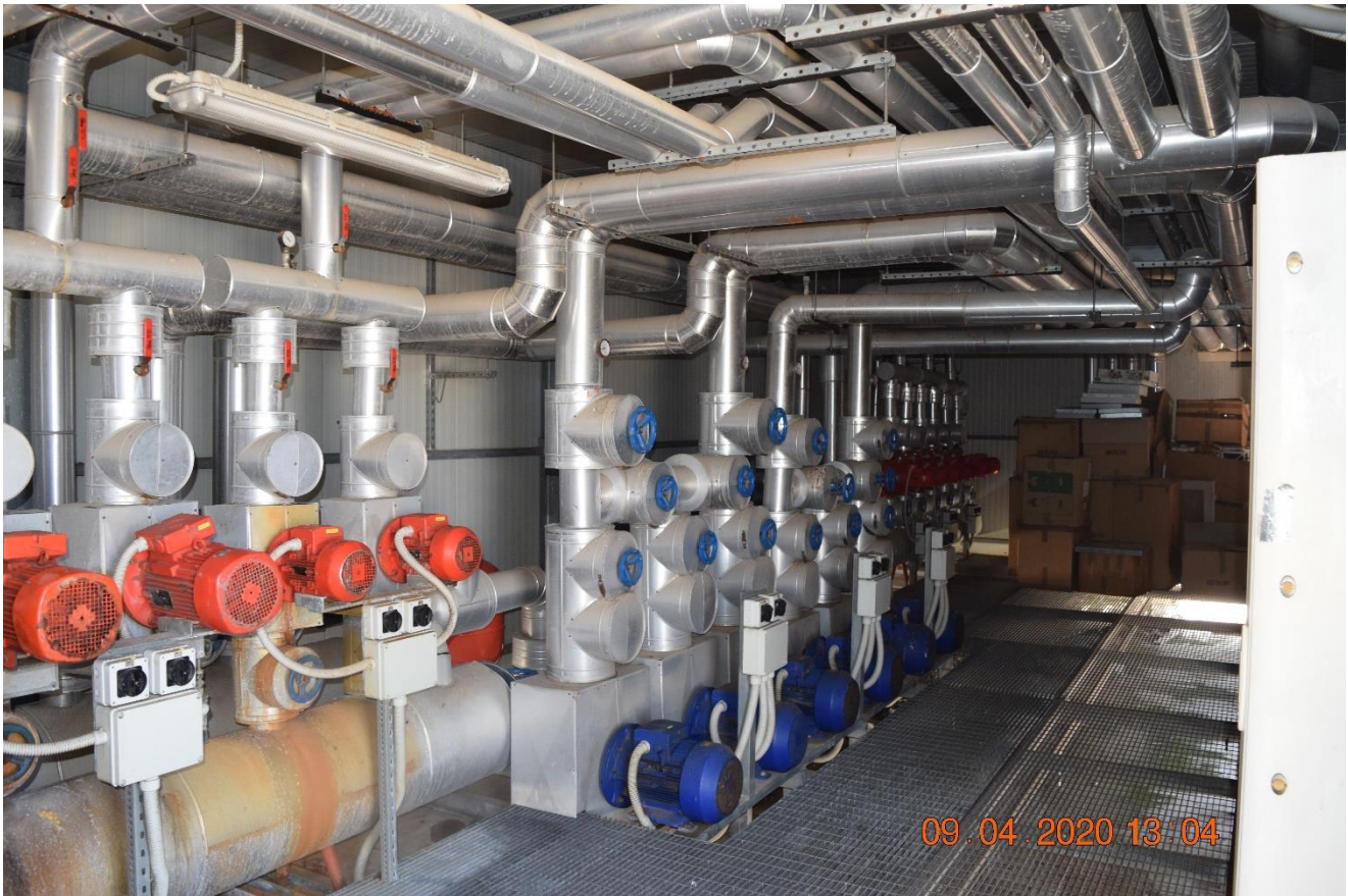
Figura 25 - Locale pompe di circolazione in copertura
