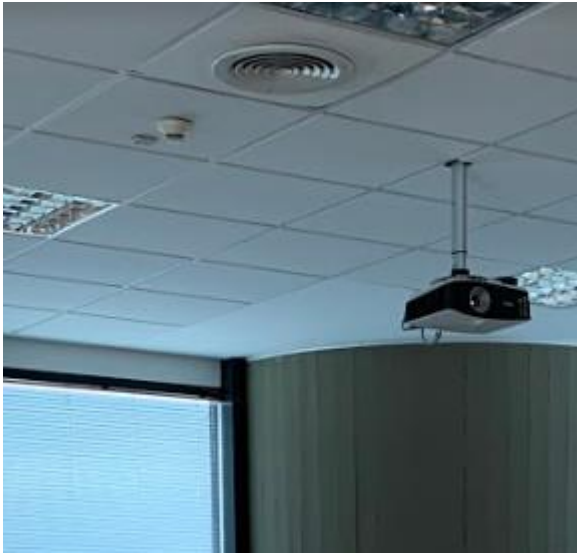
Figura 30 – diffusori a controsoffitto
