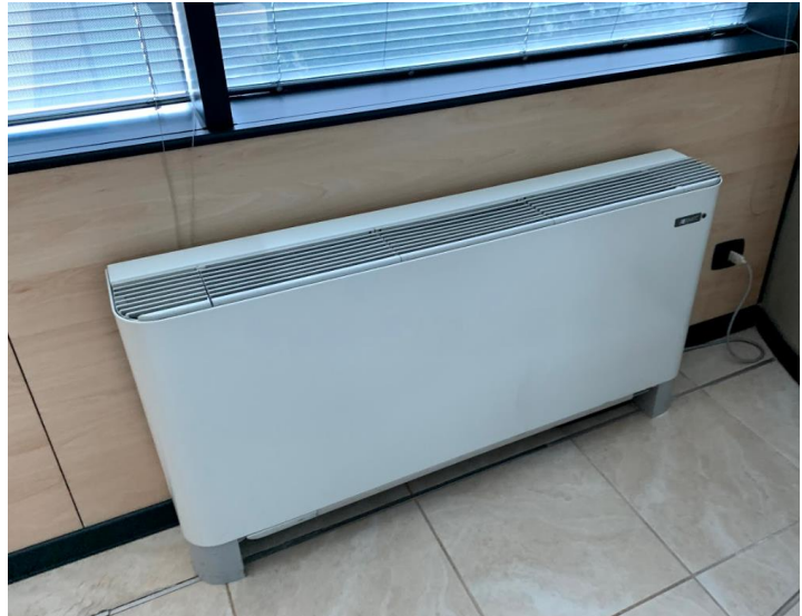
Figura 31 – ventilconvettori a pavimento
